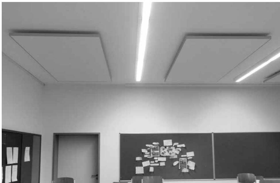
Die einfachen Absorber in den akustisch sanierten Klassenzimmern.
